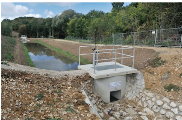
Ouvrage de dérivation en entrée du bassin. Crédit Cerib
